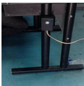
รูปที่ 3.5 การติดตั้งเซนเซอร์ตรวจจับความเคลื่อนไหว (PIR Motion Sensor)
