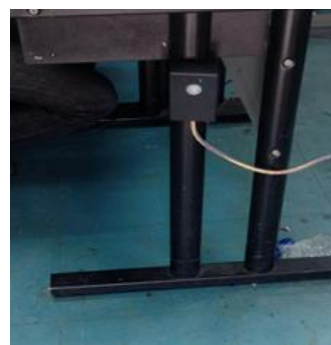
รูปที่ 3.9 การติดตั้งเซนเซอร์ตรวจจับความเคลื่อนไหว (PIR Motion Sensor)
